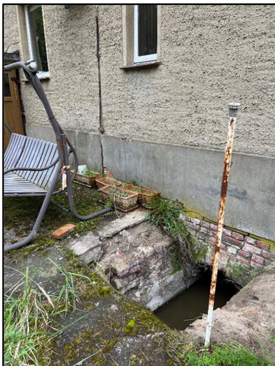
offene Abwasserableitung unter dem Haus
