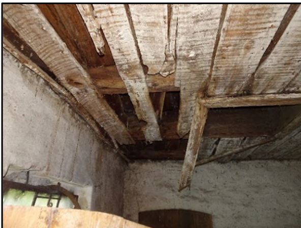
Nebengebäude marode Zwischendecke
