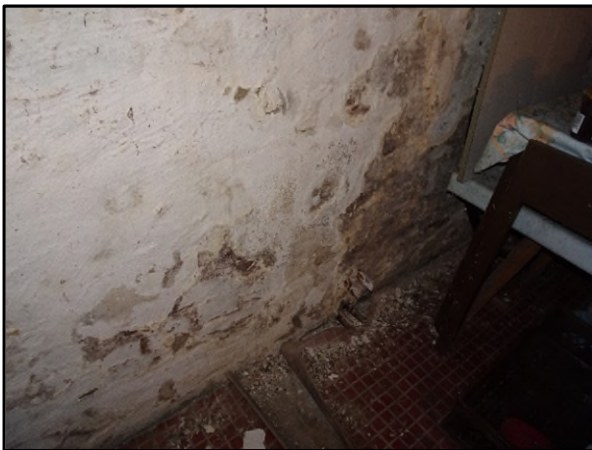
Keller Detail Feuchtigkeit
