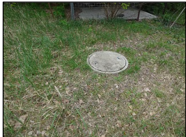
Abwassersammelgrube (2021, nicht angeschlossen)
